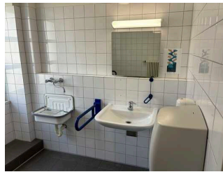
Öffentliches WC im Bereiche des Speiseraumes (Eingang Turmzimmer)
